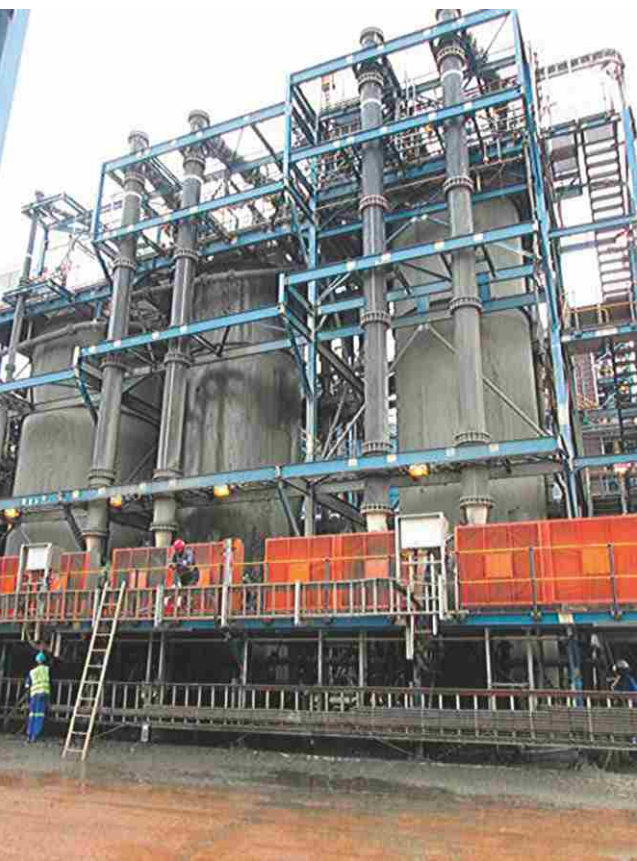
Рис. 4. Комплекс колонного выщелачивания с реакторами Aachen на руднике Kibali
